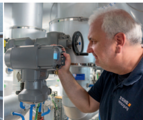
Wärmeübertrager 250 kW mit zugehöriger Pumpe (links). Funktionskontrolle Stellantrieb einer Absperrarmatur (rechts).
