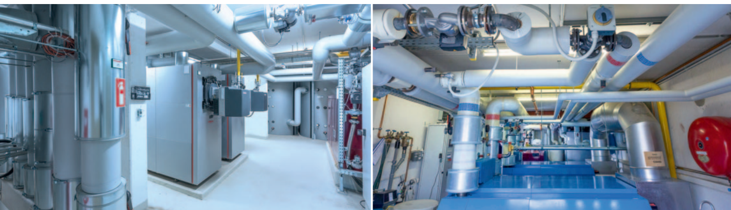
Nahwärme-Brenner im neuen Wohngebiet Waldviertel (links) und in Taunusstein-Hahn (rechts).
