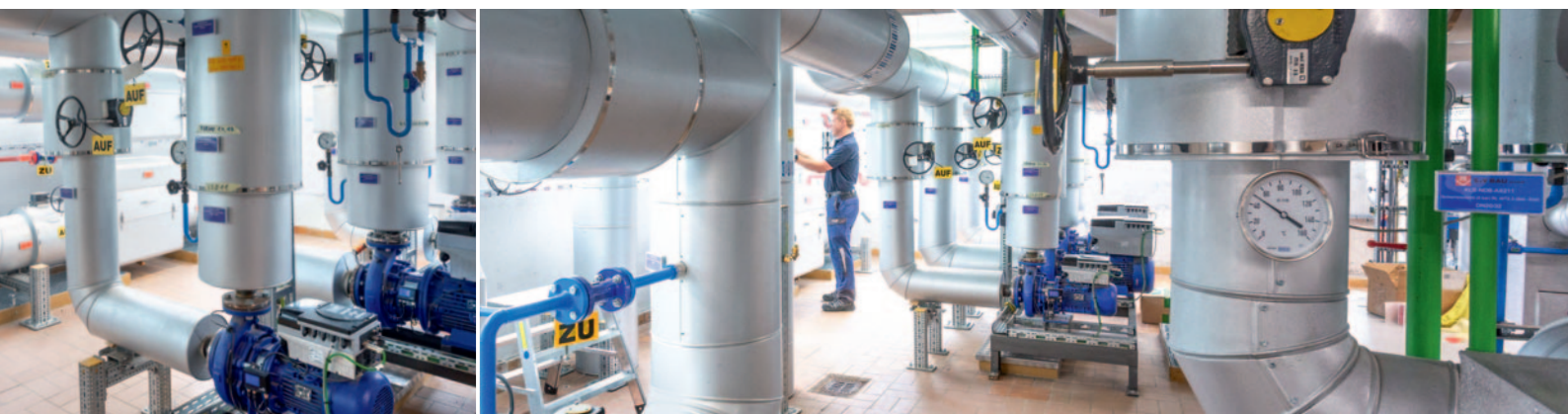
Versorgungspumpen Fernwärmenetz Wiesbaden- Klarenthal (Süd).
