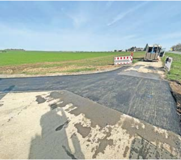
Der Kreuzungsbereich der Feldwege befand sich in keinem guten Zustand.
