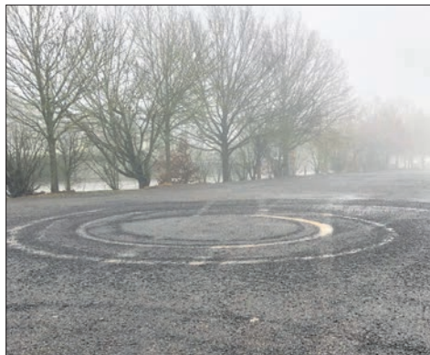
Unbekannte haben tiefe Furchen auf dem frisch sanierten Bremthaler Festplatz verursacht.
