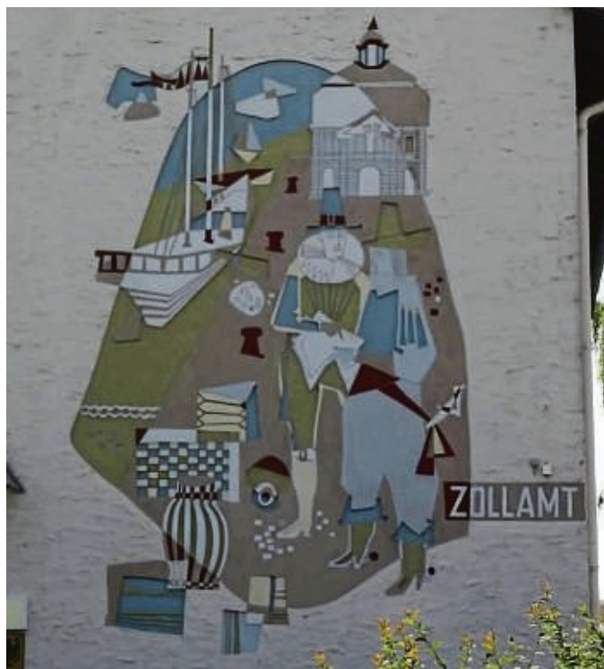
Das Sgraffito-Kunstwerk ist inzwischen hinter der Wärmedämmung verschwunden.
