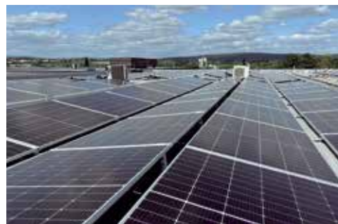
Photovoltaikmodule auf dem Dach des Hauptgebäudes
