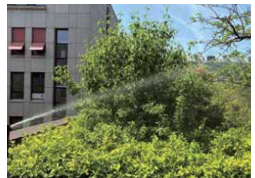
Beregnungsanlage für Dachbegrünung, durch Online-Wetterdaten gesteuert
