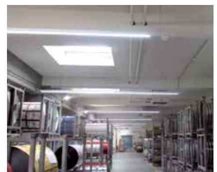
LED-Beleuchtung mit Bewegungsmelder im Lager E1
