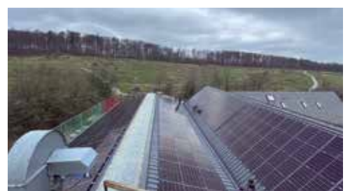
Neue Photovoltaikanlage auf dem Dach der Maschinenhalle
