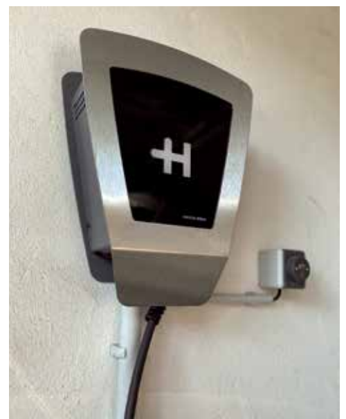
E-Ladestation für Firmenfahrzeug
