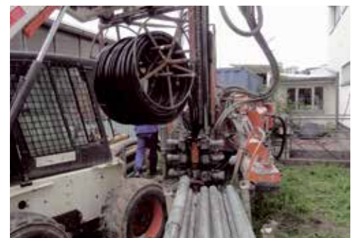
Mit Geothermie kühlen und heizen
