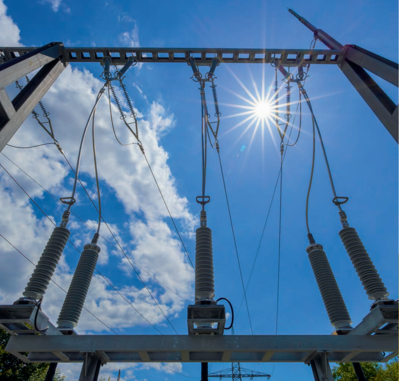
Erneuerung des Umspannwerkes Wiesbaden-Bierstadt. Die neue 110-kV-Schaltanlage sichert die Netzverfügbarkeit und -sicherheit in Wiesbaden.
