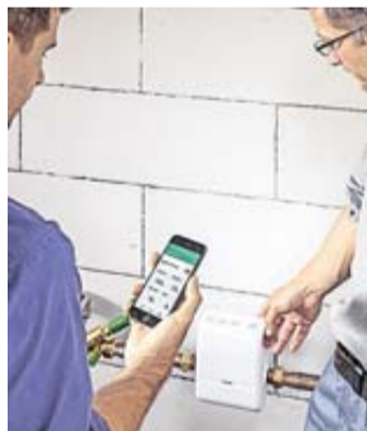
Moderne Wassersteuerungen sind auch per App bedienbar. Foto: DJD/REHAU
