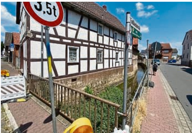
Die marode Fallbachbrücke an der Friedrich-Ebert-Straße ist seit Langem ein Sanierungsfall und kann nur noch einspurig befahren werden. ARCHIVFOTO: REINHARD PAUL
