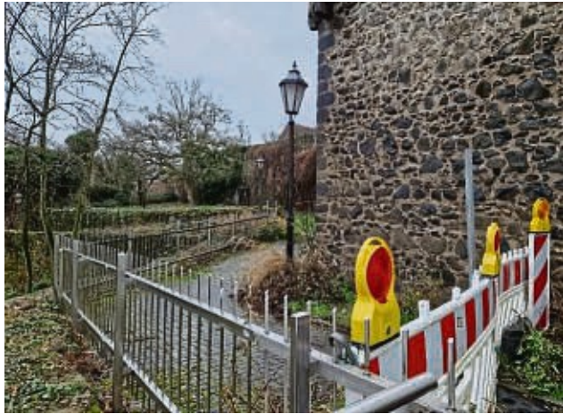
Sperrung wegen der Stadtmauer-Schäden.
