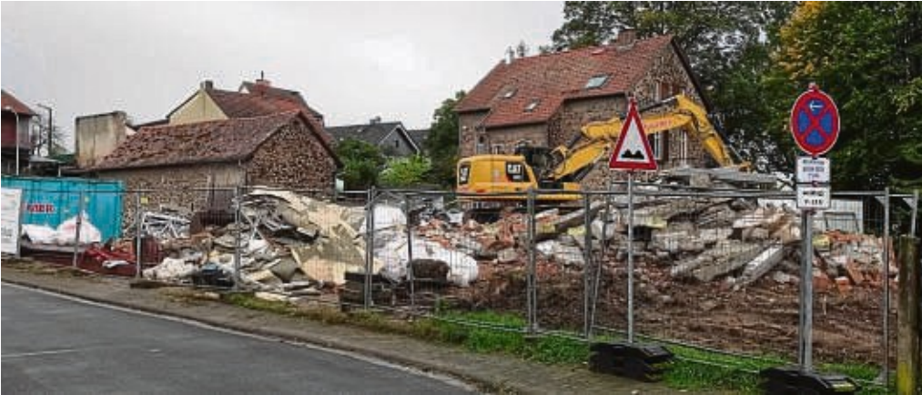
Liegt jetzt in Trümmern: Das Gemeindehaus in Ravalzhausen, in dem früher so manches Fest gefeiert wurde.
