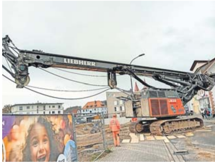
Mit einem Tieflader wurde das rund 100 Tonnen schwere Spezialbohrgerät in der Bahnhofstraße angeliefert.
