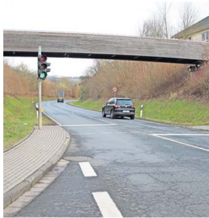
Die Fußgängerbrücke am Schlüchterner Stadtrand, die nach einem Verkehrsunfall komplett gesperrt ist, soll voraussichtlich nach Ostern wieder geöffnet werden. Foto: Stadt Schlüchtern
