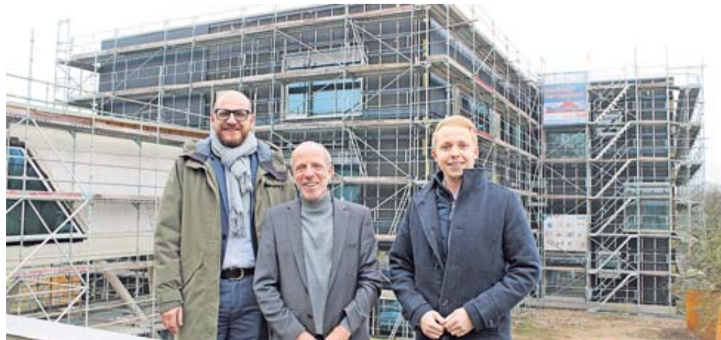
Die Bauarbeiten am neuen Gebäude D des Albert-Einstein-Gymnasiums in Bischofsheim befinden sich auf der Zielgeraden, wovon sich Matthias Eckhardt, Leiter des Amts für Schulwesen, Bau- und Liegenschaftsverwaltung und Zentrale Dienste des Main-Kinzig-Kreises, Schulleiter Claus Wörn und der Kreisbeigeordnete Jannik Marquart gemeinsam ein Bild machen konnten (von links).
