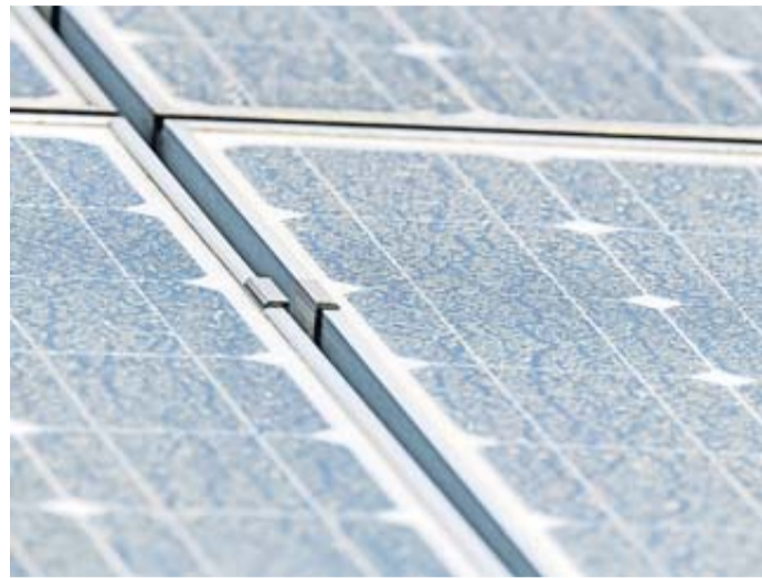
Im Frühjahr lohnt sich ein Blick aufs Dach: Hauseigentümer sollten ihre Solaranlage auf Verschmutzungen oder Schäden prüfen. Foto: Patrick Pleul/dpa-Zentralbild/dpa-mag
