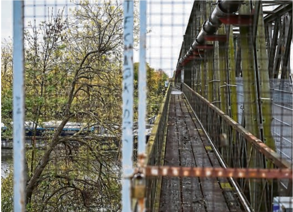
Vertrauter Anblick: Seit Sommer 2023 ist die Auheimer Fußgänger- und Radfahrerbrücke aufgrund ihres baulichen Zustands gesperrt. Sie ist nicht die einzige Brücke in Hanau, die in den kommenden Jahren saniert oder sogar neu gebaut werden muss. FOTO: PATRICK SCHEIBER
