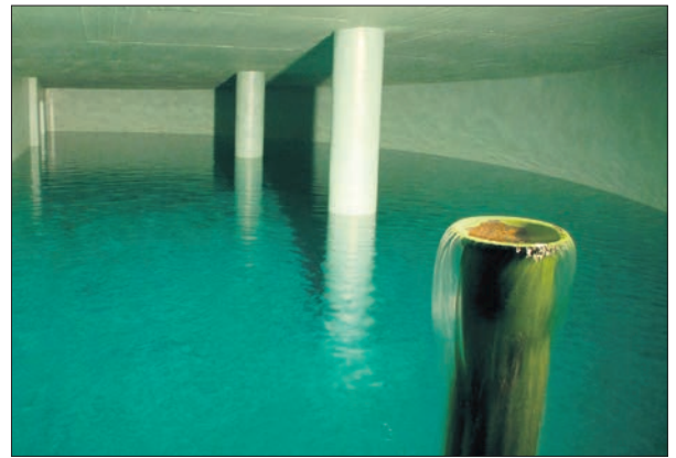
Wasser im Hochbehälter am Heinzberg. Archiv-Foto EZ
