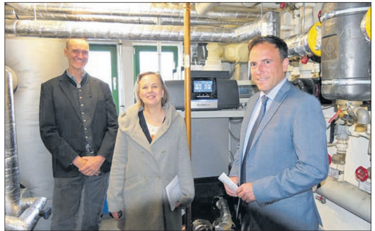
Installateurmeister Rüdiger Lang, Stadtarchitektin Annette Kunkel und Bürgermeister Alexander Simon im Technikraum. Foto: Jochen Haupt
