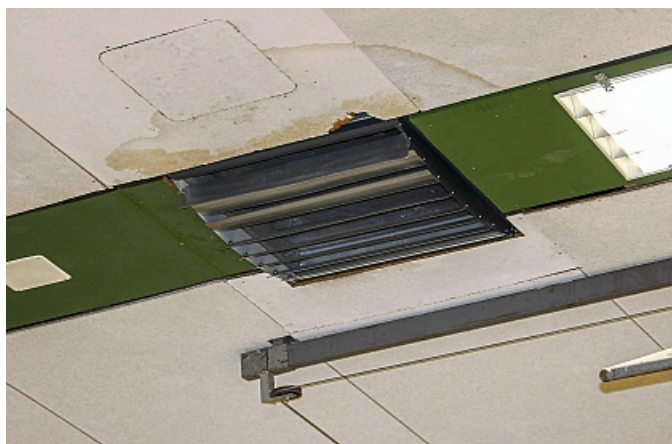
Bereits im März 2021 trat das Wasser durch die Decke in das Halleninnere ein.
