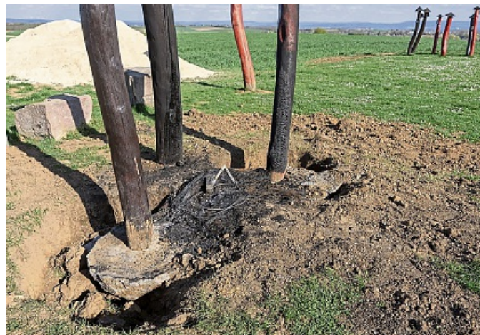
Mit großem Aufwand wurden die Fundamente der Stelen freigelegt und die Pfähle umgerissen, wohl mit einem Fahrzeug.
