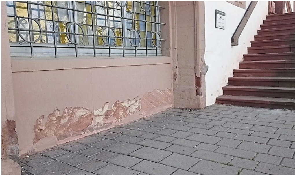
Ganz deutlich zu sehen sind die Abplatzungen auf Sockelhöhe der Goldschmiedehaus-Fassade.
