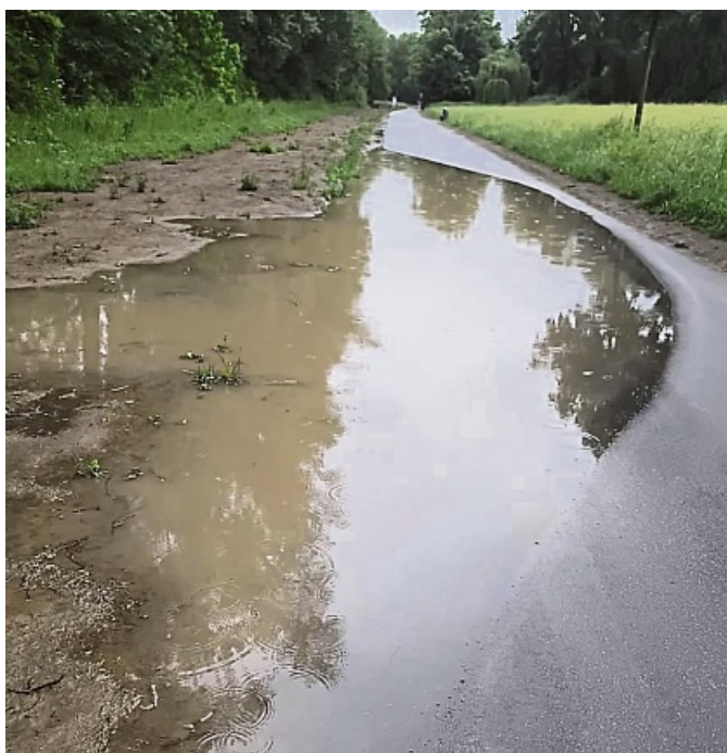
Die Entwässerung einiger Bereiche des Mainradwegs erweist sich als hartnäckig. Nach den starken Regenfällen Anfang Juni stand dort das Wasser.
