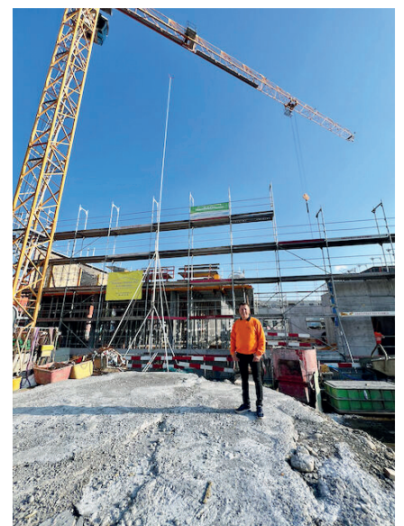
Maya-Firmenchef Muhris Bakimci auf seiner Baustelle: Der Name seiner Frau schmückt die Umzugsfirma.
