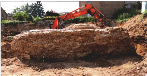
Abb. 3: Bollwerkfundamentrest nach der Freilegung von Osten gesehen. Deutlich erkennbar ist links der Ansatz des Entlastungsbogens (Foto: msterraconsult, D. Meyer)
