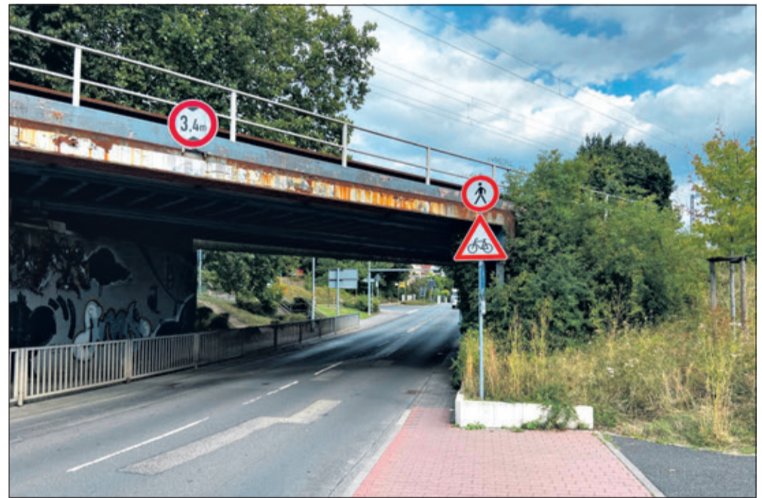
Zu eng und gefährlich: Die Unterführung auf der Sulzbacher Straße darf nur auf dem gesicherten Gehweg – hier links – erfolgen. Foto: Stadt Bad Soden
