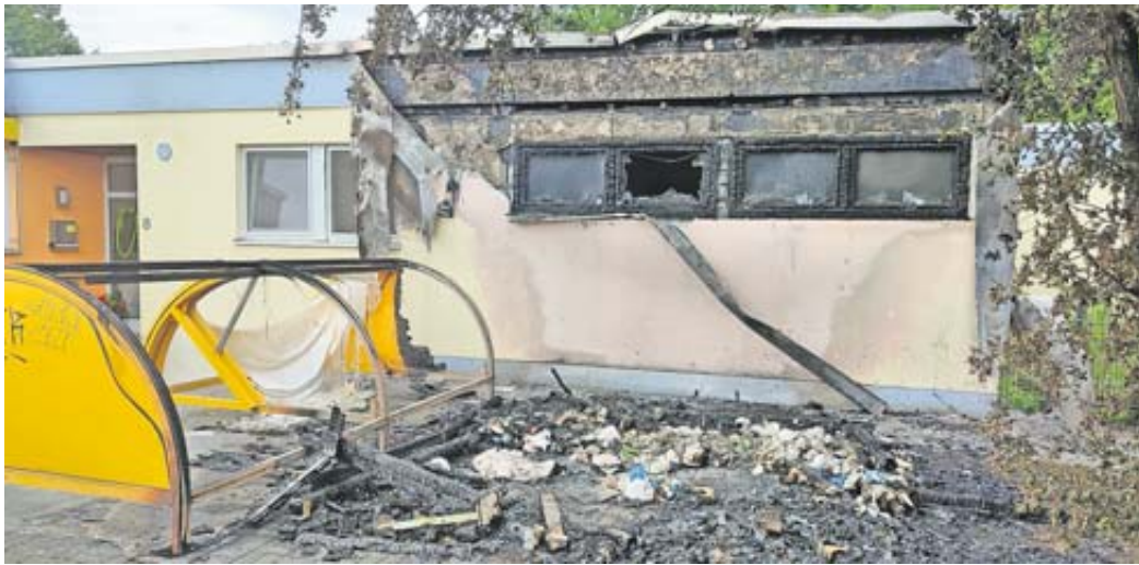
Der Schaden von außen.
