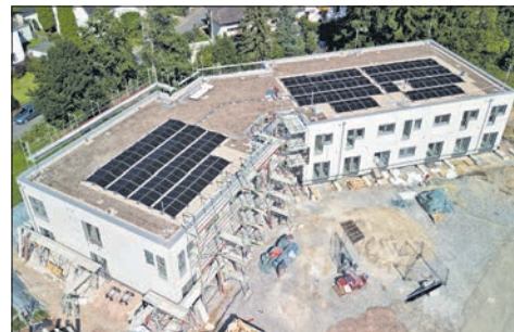
Module der Photovoltaik-Anlage.
