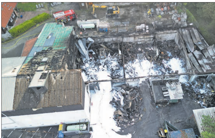
Ein Bild der Verwüstung nach dem Großbrand im Lager eines Reifenhandels im Gewerbegebiet Lochmühle in Niedernhausen-Oberseelbach. Foto: Jochen Haupt
