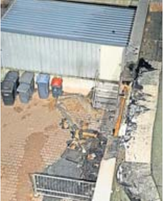
An der Turnhalle in der Peter-Fleischhauer-Straße zogen die Flammenschäden von außen an und in das Gebäude, wes- halb die Halle gesperrt werden muss.
