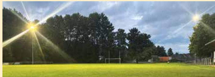
Sie leuchten hell, sie leuchten warm: Das modernisierte Flutlicht am Sportplatz des SV Melitia Aufenau eignet sich künftig auch für den Ligaspielbetrieb.
