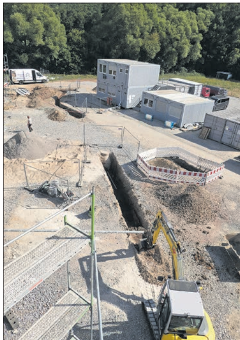
Noch ist der Vorplatz eine Baustelle. Sie ist umgeben von Grün und altem Baumbestand.
