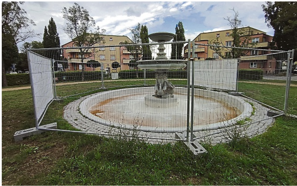
Nachdem ein alkoholisierte Autofahrer den Schwanenbrunnen gerammt hat, ist das Wasserspiel außer Betrieb. Die Sanierung gestaltet sich aufwendig.
