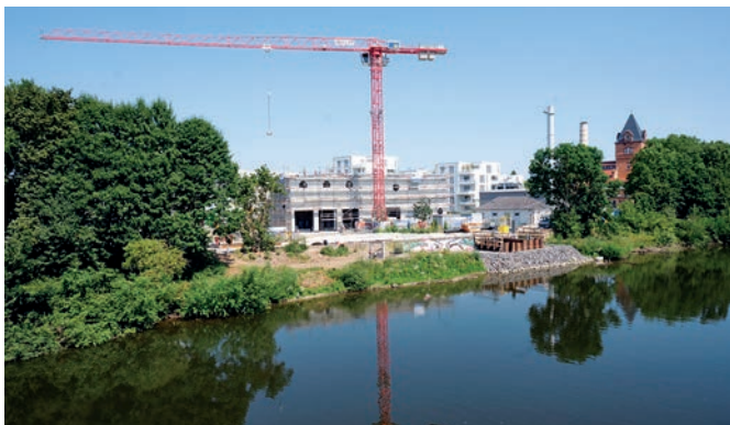
Knapp drei Jahre nach dem Planungsbeginn steht die Energiezentrale in der Schlachthofstraße kurz vor der Fertigstellung.
