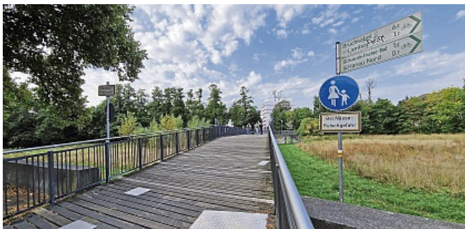
Hie und da musste der bei Nässe rutschige Belag des Kinzigstegs bereits geflickt werden. Auch das Tragwerk ist sanierungsbedürftig.
