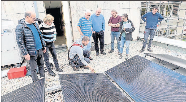
Dr. Florian Grohs, UrStrom, Magda Dewes, BEG, ein Mitarbeiter der Firma inek, Hans-Jürgen Veit, BEG, Wolfgang Seel, Gemeinde, Levin Streit, UrStrom, Daniela Kreckel, ries und ries, ein weiterer inek-Mitarbeiter (v.l.n.r.) bei der technischen Abnahme der Anlage. (Foto: Klaus Neuhaus)
