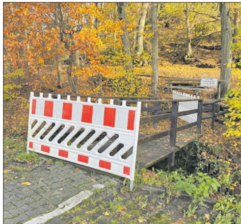
Die Brücke über den Silberbach ist gesperrt. Foto: Eva Palmert
