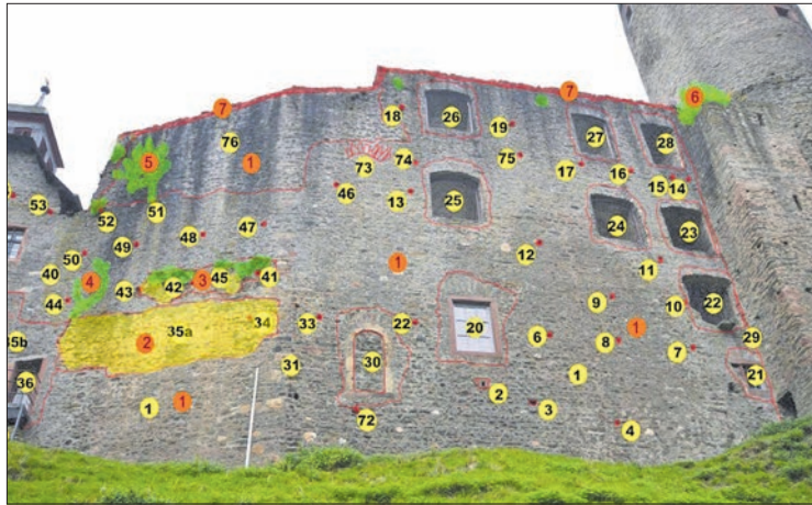
Zu Beginn der Maßnahme werden Befunde und Bauschäden an der Nordmauer markiert. Foto/Grafik: Joachim Zeune
