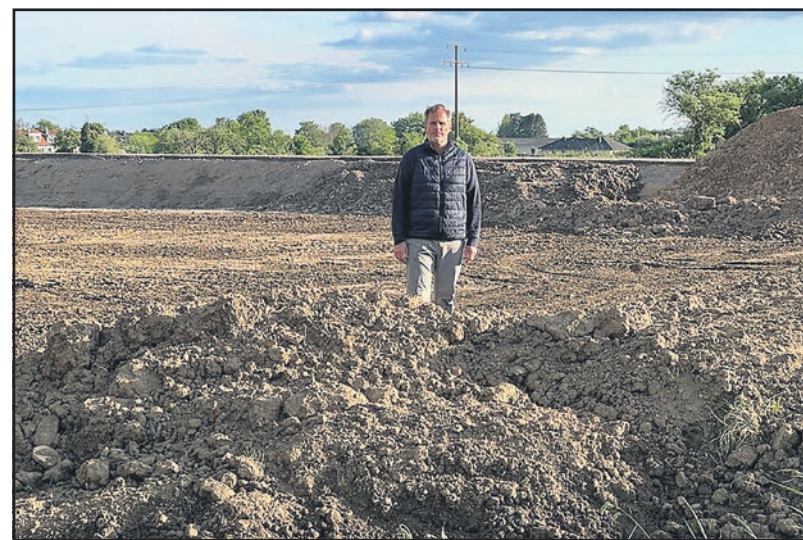
Heiko Hildebrandt steht vor dem Regenrückhaltebecken.
