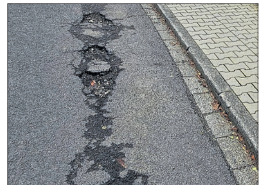
Solche Schlaglöcher und Schäden lässt die Stadt wie jedes Jahr beseitigen.
