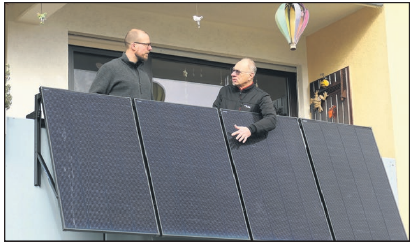
Ruben Leinberger und Jürgen Galinski an einem Steinbacher Balkonkraftwerk Foto: Dennis Komp
