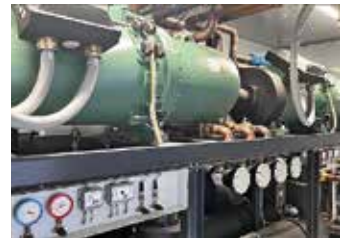
Energiesparende Kältetechnik von L&R, hier für die Herstellung von Glasfaser-Infrastruktur bei Egeplast in Greven
