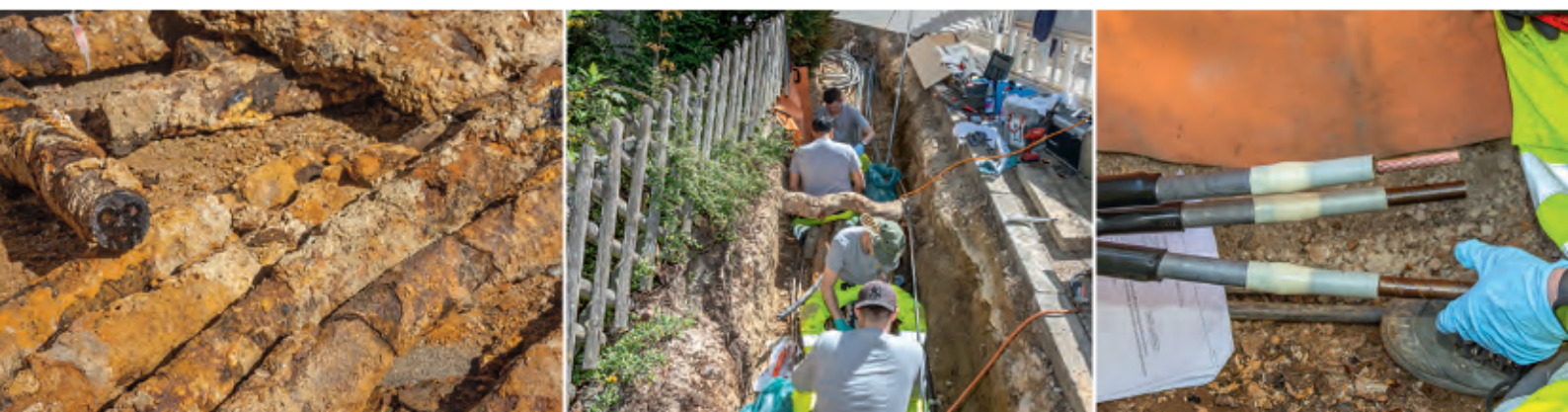
Papierisoliertes 20-kV-Kabel im alten und neuen Zustand.
