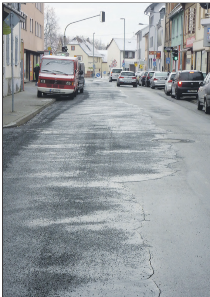
Gut geschüttelt werden Radler und Autofahrer auf der Sindlinger Bahnstraße.
