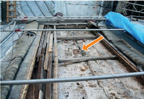
Erdbebenriss vor dem Aufbringen eines Klammerpflasters aus Mörtel und Carbonbewehrung
