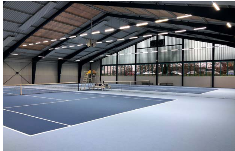
LED-Beleuchtung in der neuen Tennishalle (Umrüstung 2018)
