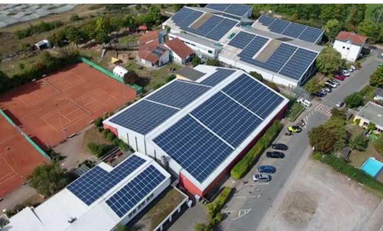
Komplettansicht Photovoltaikanlagen in der heutigen Ausbaustufe (2021)
