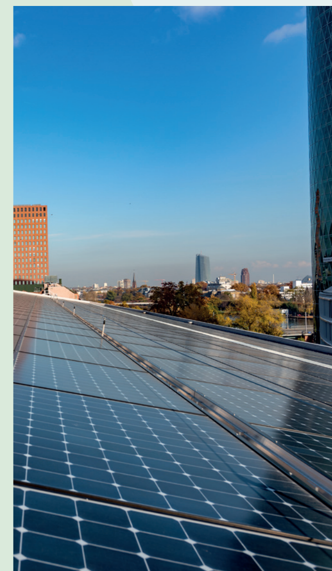
Photovoltaik-Anlage auf dem Dach des Aktiv-Stadthauses in der Speicherstraße
