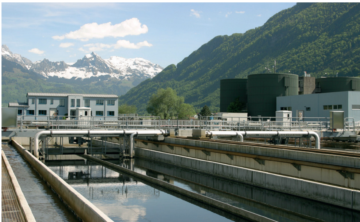
Abbildung 15: Klärwerk zur Abwasserreinigung. (© Pixabay / kubinger)
