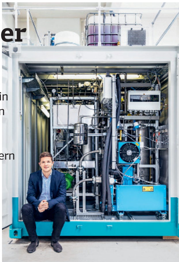
Erfolgsprodukt Daniel Teichmann mit der Anlage, die den Wasserstofftransport möglich macht.
