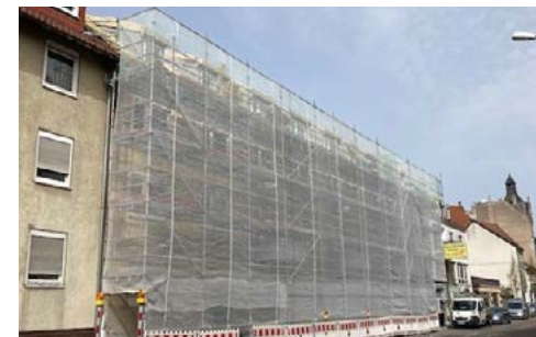
In der Wormser Wohnanlage Friedrichstraße mit 16 Wohneinheiten wird sich die Energieeffizienz von Klasse F auf B verbessern. Hier wurde allerdings die Fertigstellung durch einen Baustellenbrand um ein Jahr verzögert, weshalb sämtliche betroffenen Bewohner in Ausweichquartieren untergebracht werden mussten.
