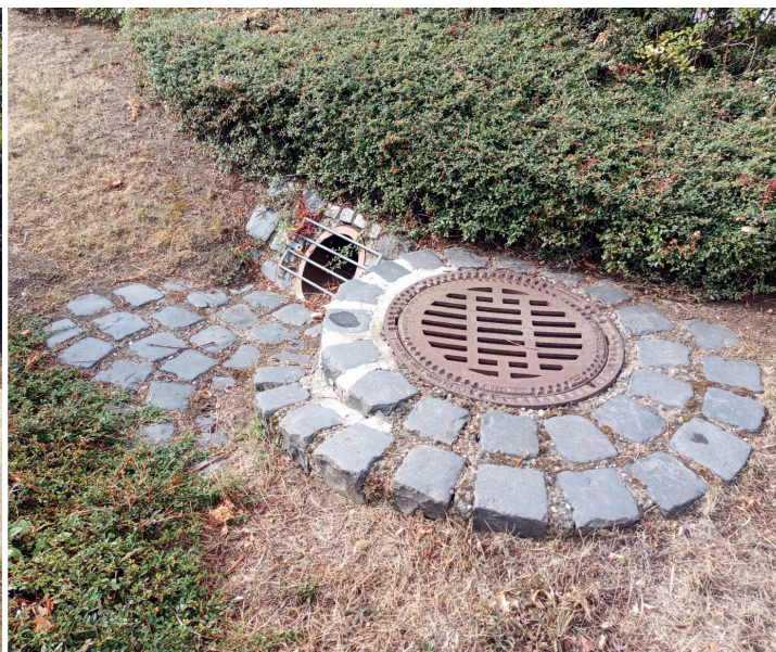
Ablauf einer Regenwassermulde in einer kleinen Verkehrsgrünfläche mit nebenliegendem Mulden-Überlauf, Dietrich-Bonhoeffer-Weg (Baugebiet Friedberger Warte/Atterberry), September 2022
