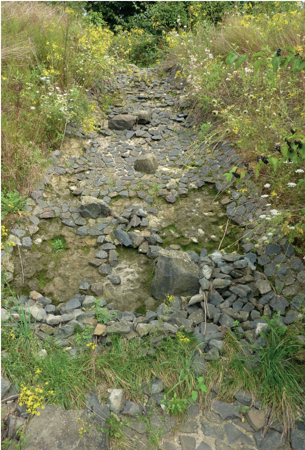
Aus Fehlern lernen: Gewerbegebiet Am Martinszehnten. Die Kraft des Wassers ist stark. (Steine zu klein und falsche Bettung)
