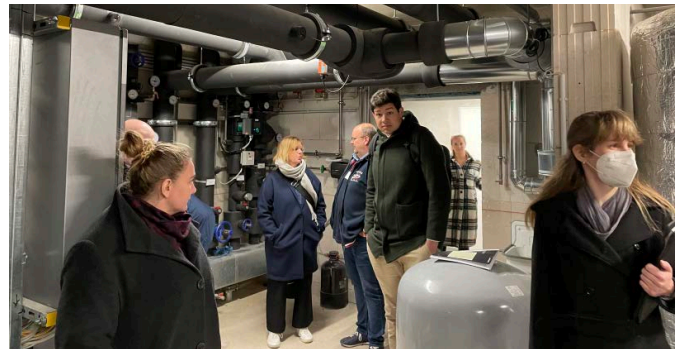
Die Wärmeversorgung wird über eine Wärmepumpe und einen Eisspeicher ermöglicht.
