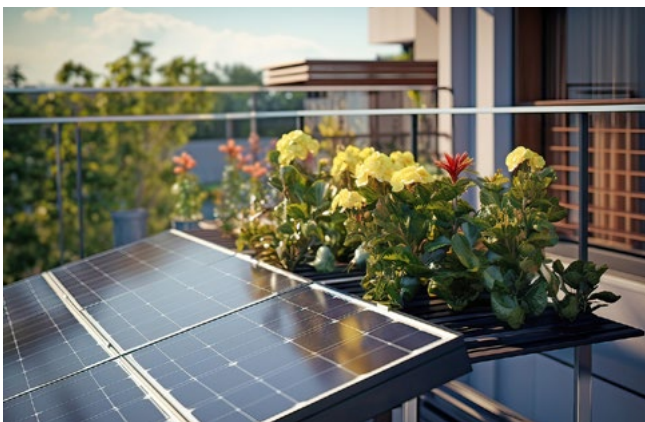
Stromerzeugung mit einem Minikraftwerk auf dem Balkon.
