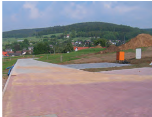
Erbach-Ost im Jahr 2004: Die Infrastruktur der ersten Bauabschnitte mit Straßen und Versorgungsleitungen ist bereits fertiggestellt, die Grundstücke sind gebildet, um an die neuen Eigentümer und Bauherren veräußert zu werden.
